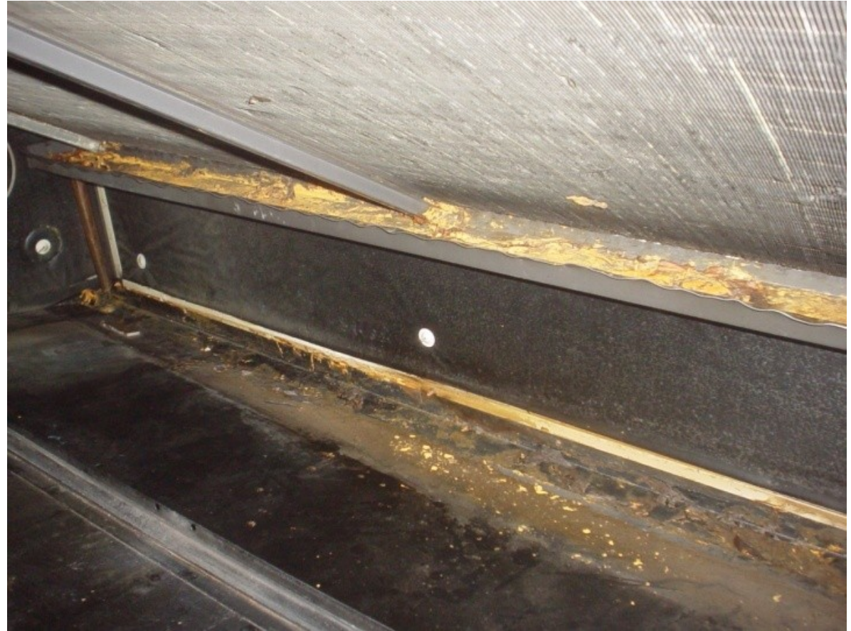
1ヶ月後の観察。ヌメリが分解し排水された
